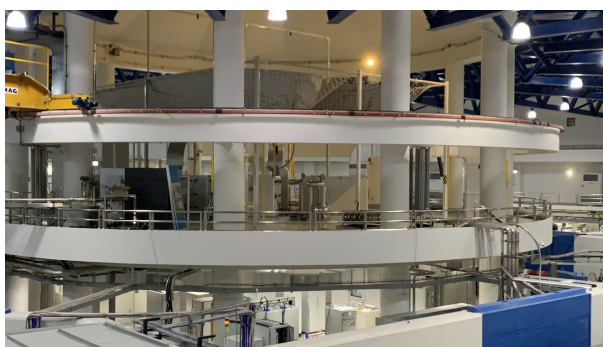
รูปที่ 12 ภาพแสดงการติดตั้งเครื่องส่งลมเย็นใหม่ AHU-5,6,7,8 ขนาด 210,000 บีทียู จำนวน 4 ชุด
